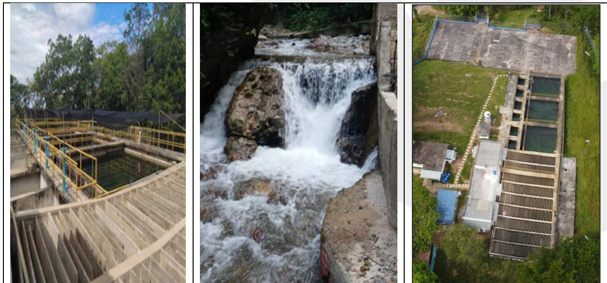
Figura 5. Componentes del sistema de acueducto.
